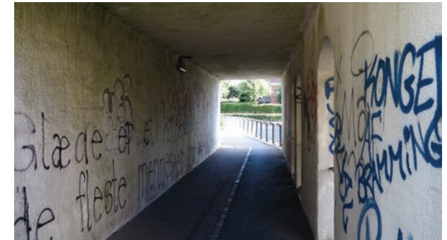
Fodgængertunnel trænger til renovering og belysning
